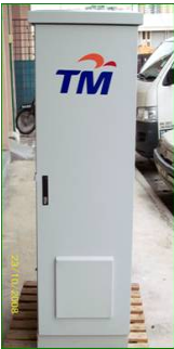
OUT DOOR MPOC CABINET
